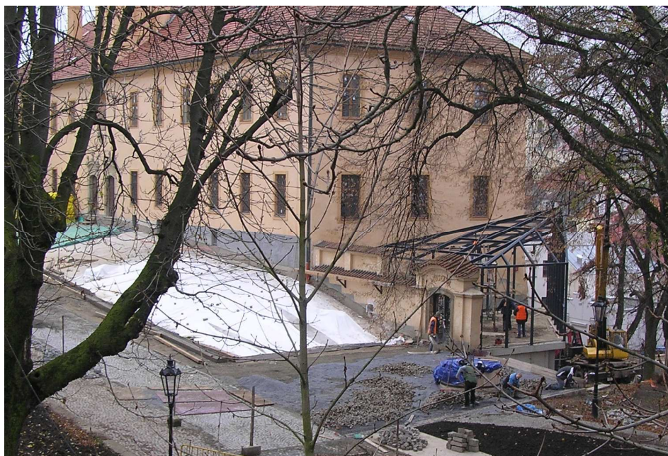
Vlevo suterénní ochranný objekt nad archeologickými nálezy, vpravo montáž ocelového skeletu budoucího vstupního foyer. foto René Klimeš 18. 11. 2013
